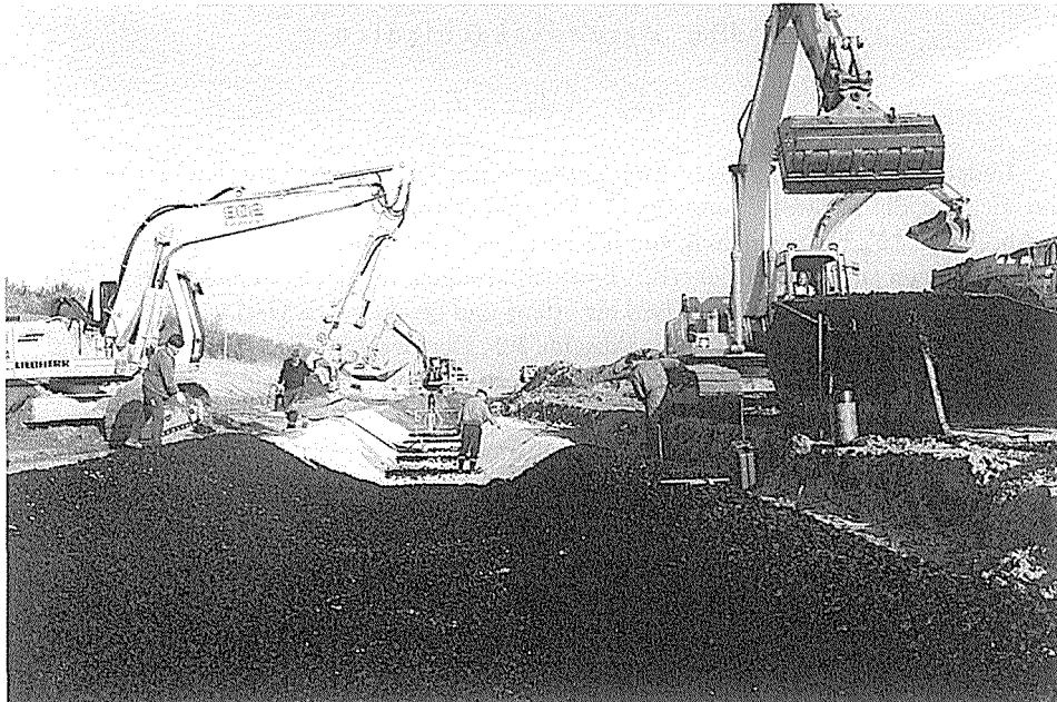
Abb. G 55a: Deich im Tidebereich des Elbe-Ästuars bei Glückstadt mit höherem Vorland, deshalb mit einem wasserseitigen Entwässerungsgraben mit einem erosionsfesten offenem Deckwerk aus Mastixgestein auf geotextilem Filter zur schnelleren Wasserabführung
