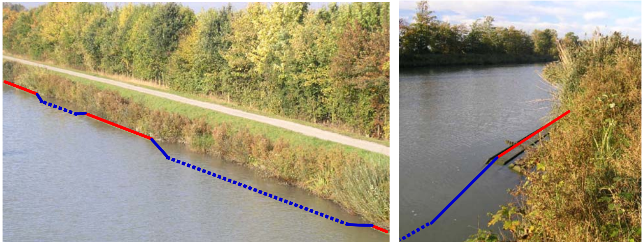
Bild 4.1: Versuchsstrecke MLK-km 189,5 bis 190,0, Nordufer Spundwand endet kurz über (rot) bzw. unter (blau) dem Wasserspiegel ( BW_o )
