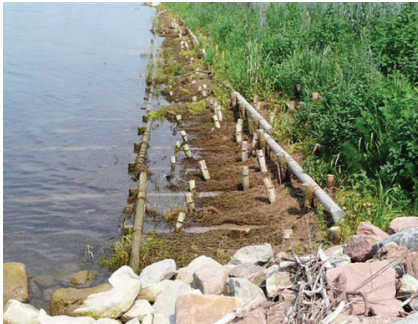
Bild 12: Pflanzmatten im VF 7 im unteren stark belasteten Böschungsbereich (30.05.2013)
