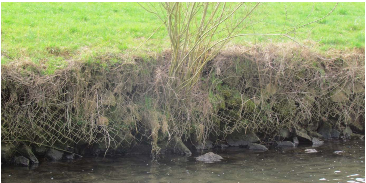
Abbildung 17: Linienhaft abgeschnittene Mattenkörbe im Wasserwechselbereich; abgesackte und aufgebrochene Steinmatten (eigene Aufnahme März 2015, ca. bei km 76.50)
