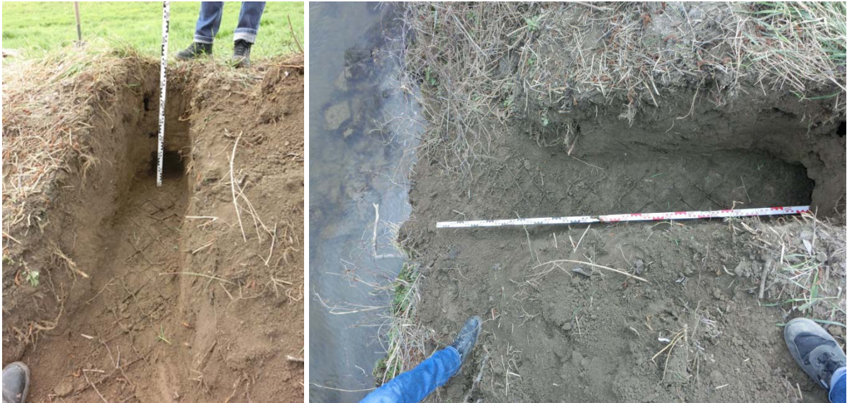
Abbildung 16: Km 78.70 (Nullprofil); Steinmatte im horizontalen Landanschlussbereich (Länge 2,0 m) noch vollständig vorhanden, ca. 80 cm Erdüberdeckung (eigene Aufnahme März 2015)
