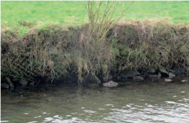
Abb. 3: Reste der Steinmatten im oberen Böschungsbereich – Ne-km 76,50 (März 2015)
