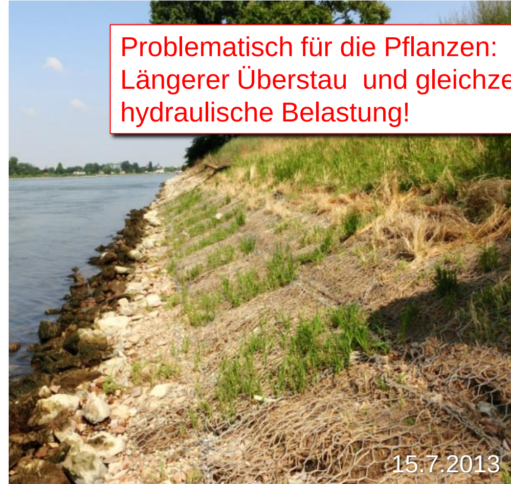
Weitere massive Schädigungen durch Hochwasser 2013 (10 Wochen Einstau) Nur noch bestimmte Pflanzenarten stabil!
