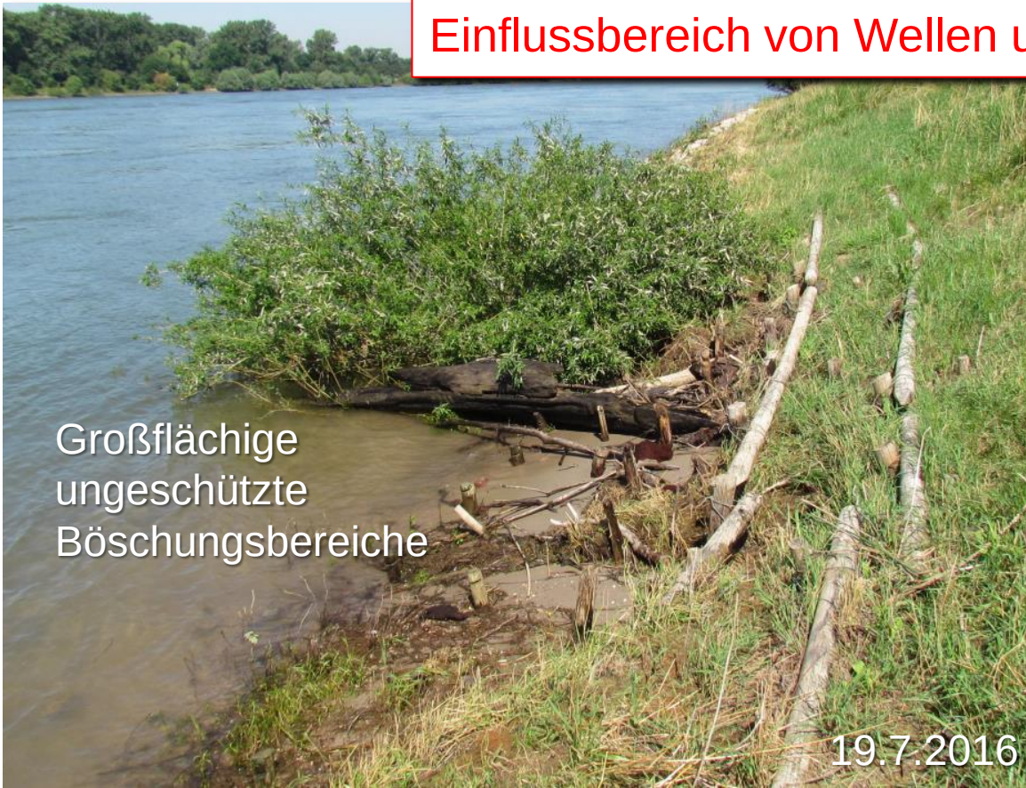
Hochwasser Juli 2016 (Wasserstand ca. 2 m über MW)
