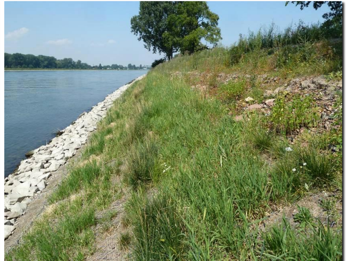
2012: Erste Schädigungen nach mehreren Überstauereignissen Anfänglich Erholung der Pflanzen
