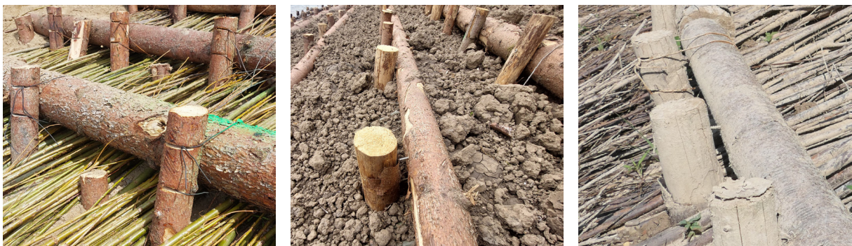
Abbildung 12: Befestigung der Querriegel beim Einbau, links: mit Draht, Mitte: mit Spax-Schrauben, rechts: Beide Varianten am 22.08.2024 (Fotos: BAW).
