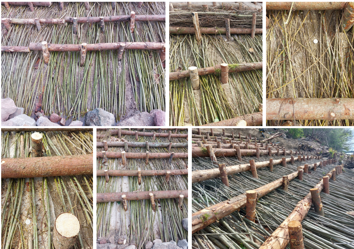
Abbildung 6: Weidenspreitlage am 17.04.2024, unten rechts: flächig verlegte Spreitlage aus Purpurweide; sonst: Spreitlage aus Korbweiden aus zu dünnen Ästen mit erheblichen Fehlstellen, die zum Größenvergleich abgebildete 2-Euro-Münze besitzt einen Durchmesser von 25,75 mm (Fotos: BAW).
