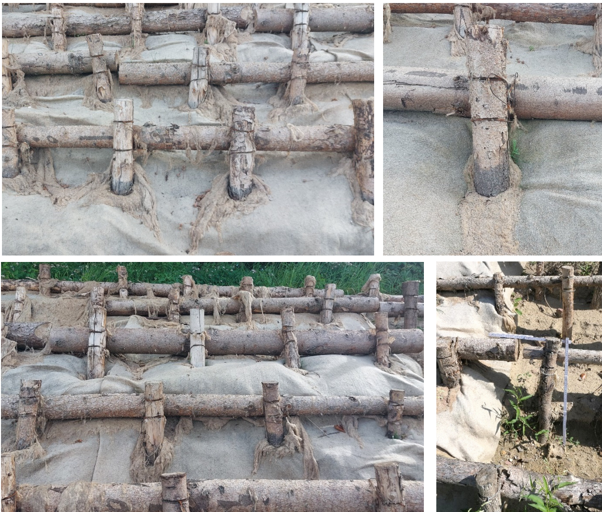
Abbildung 9: Bodenumlagerungen unter dem abbaubaren Geotextil wurden nur teilweise durch die Querrigel aufgehalten. Oben rechts: Austrag von Sand am Befestigungspflock; unten rechts: Während das Geotextil den Boden weitgehend zurückgehalten hat, ist im benachbarten Feld eine 50 cm mächtige Sandschicht erodiert. Unten rechts: Aufnahme vom 22.08.2024 sonst vom 16.07.2024 (Fotos: BAW).
