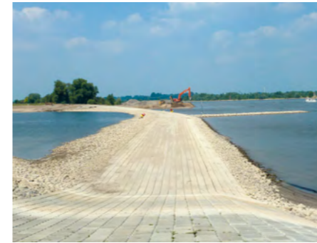
Bild 2: Überlaufschwelle am stromaufwärts gelegenen Ende der Flutmulde Rees.
