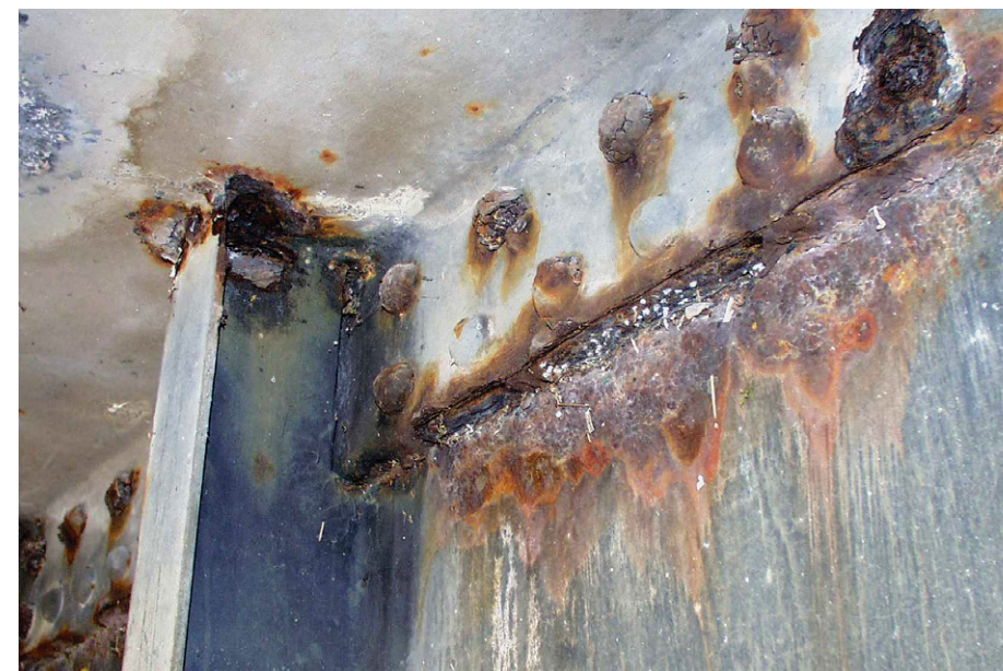
Bild 1: Korrodierter Anschlussbereich in einer Stahlwasserbaukonstruktion
