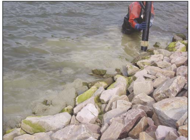
Bild 4: Beispiel für eine mangelhafte Ausführung mit einer zu großen Pumpe
