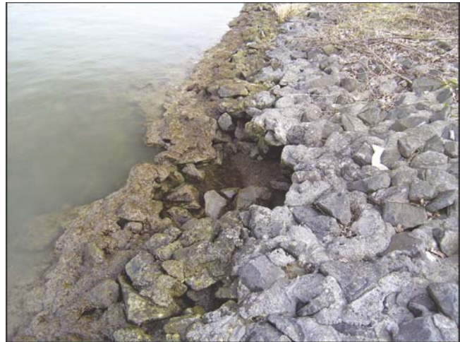
Bild 1: Uferabbrüche an einem zu dicht vergossenen, eigentlich durchlässigen Deckwerk
