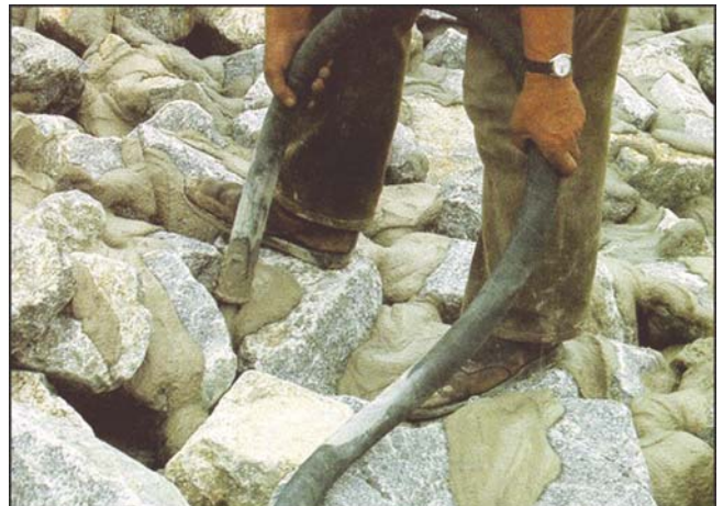
Bild 5: Beispiel für eine gute Ausführung mit einer richtig angepassten Pumpe
