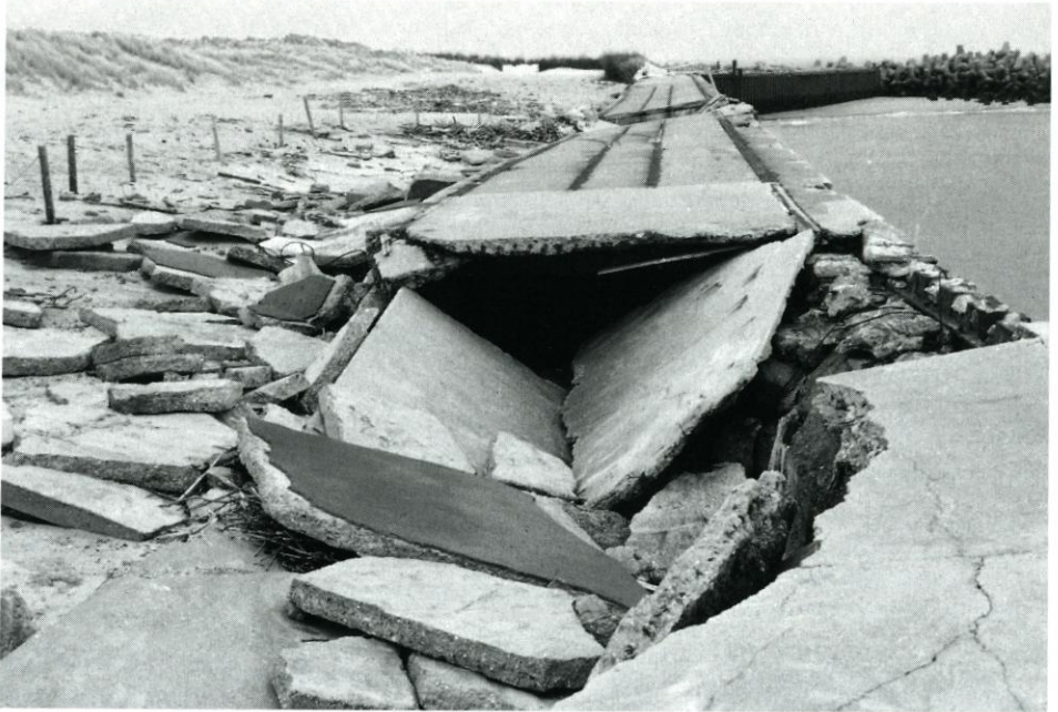
Abb. 20: Zerstörte Kaje an der Westseite der Düne
