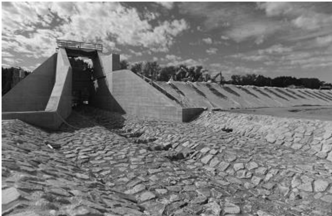
Abbildung 2: Bauzustand HRB Neuwürschnitz, Auslaufbauwerk, Tosmulde, Querriegel (ARGE HPI ARCADIS, 10/2015)
