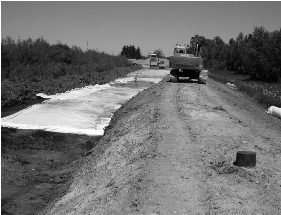
Abbildung 8: Weiterer Baufortschritt im Bereich des gering tragfähigen Baugrunds; der Dammbestand dient zugleich als Baustraße
