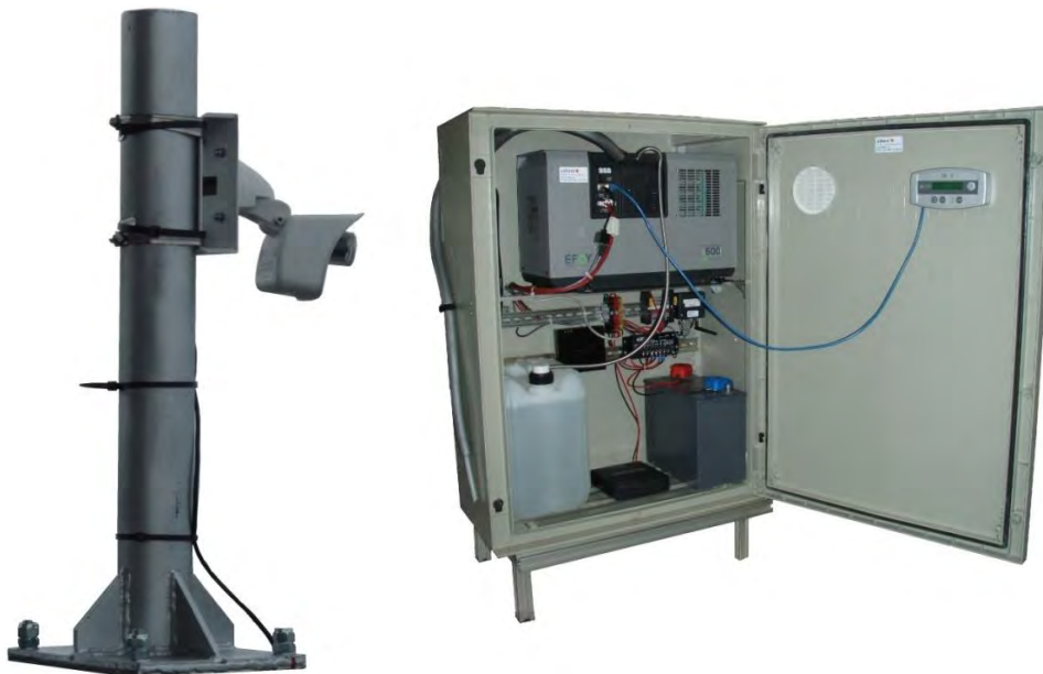
Abbildung 3: Videokamera und Schaltschrank mit eingebauter Messtechnik und Energieversorgung
