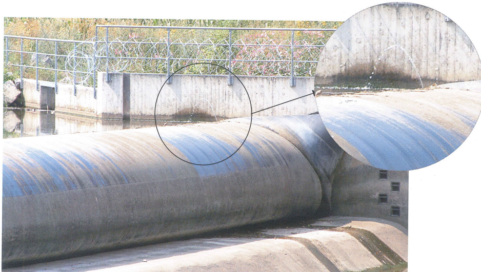
Abbildung 2: Lokaler Wasseraustritt aus einer Schlauchmembran
