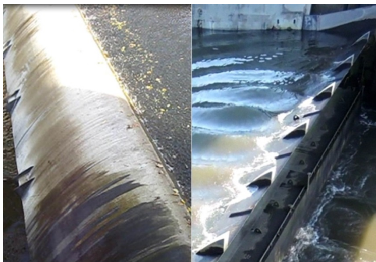
Bild 1: Wellenbild eines schwingenden Sohldichtungsträger (links) und eines Hubschützes mit Aufsatzklappe (rechts).
