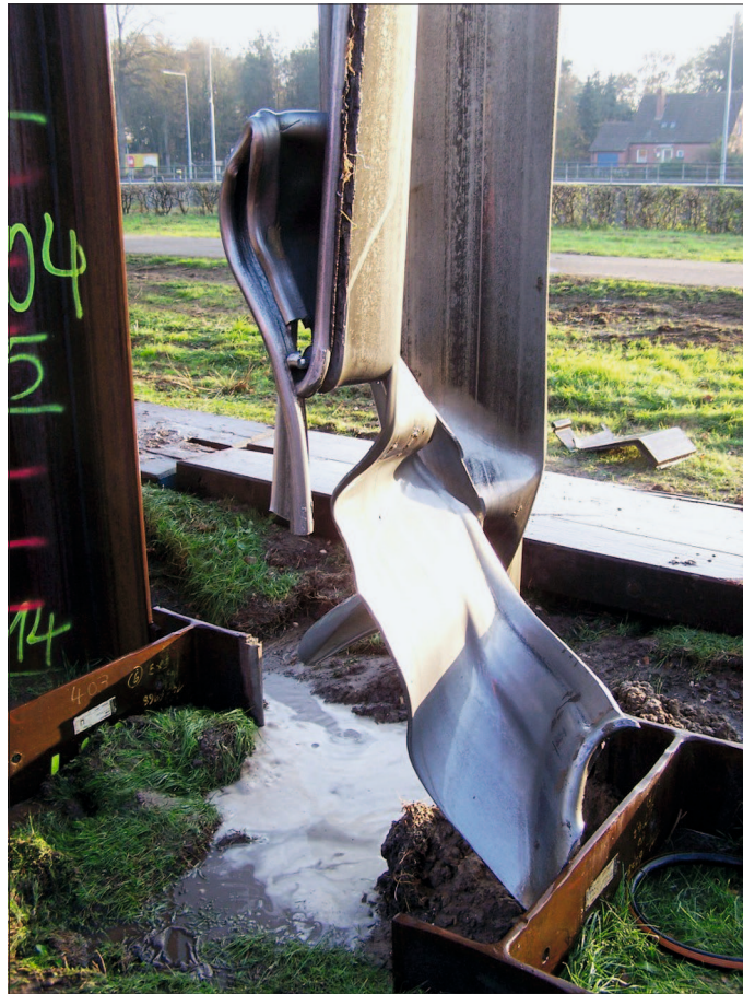
Bild 2.7: Bei Proberammung zerstörte Spundbohle Figure 2.7: Sheet pile damaged during test driving
