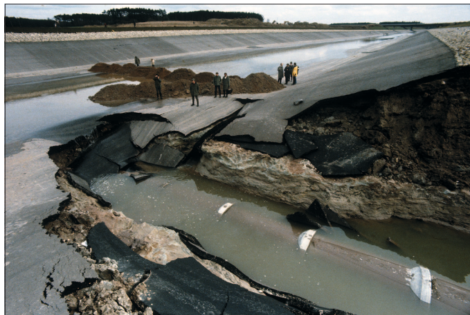
Bild 2.12: Dammbrechung am Main-Donau-Kanal mit freigelegter Wasserversorgungs-Transportleitung (Quelle: Jürgen Gebhardt/Stern/Picture Press)
