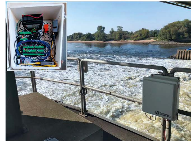
Bild 5: Beispiel Geo-Messtechnik: Loggerkästen der einzelnen Messstellen an den Pfeilern
