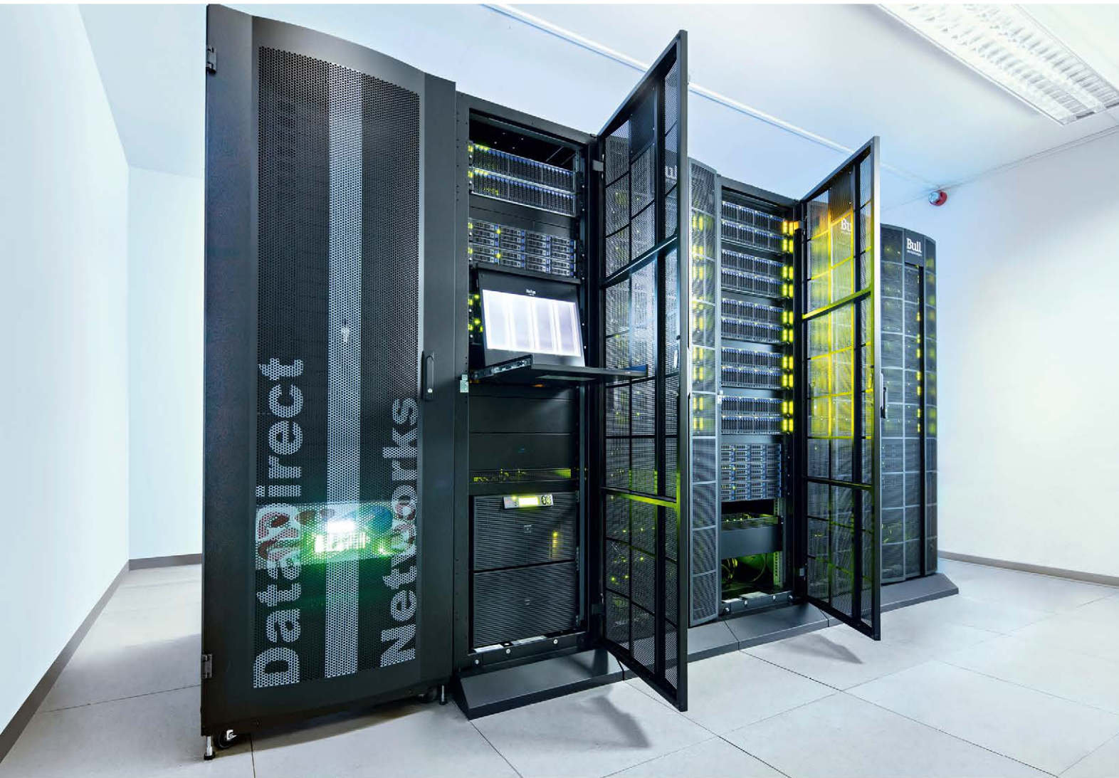
Hochleistungsrechner in Karlsruhe
