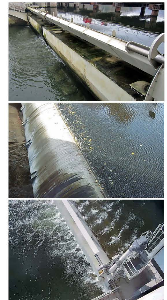
Bild 6: Wellenbild im Oberwasser einer Wehranlage bei einer Dichtungsschwingung (oben), einem schwingenden Sohldichtungsträger (Mitte) und einem schwingenden Verschluss (unten)
