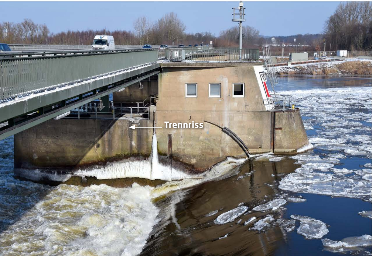
Bild 1: Wehrpfeiler: Trennriss und Eisbeanspruchung
