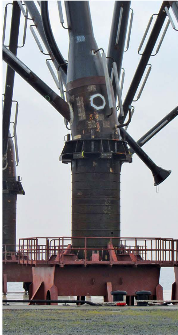
Bild 3: Detail eines Jackets mit Lagervorrichtung, oben Korrosionsschutzbeschichtung und angefügte Opferanoden, Ostsee
