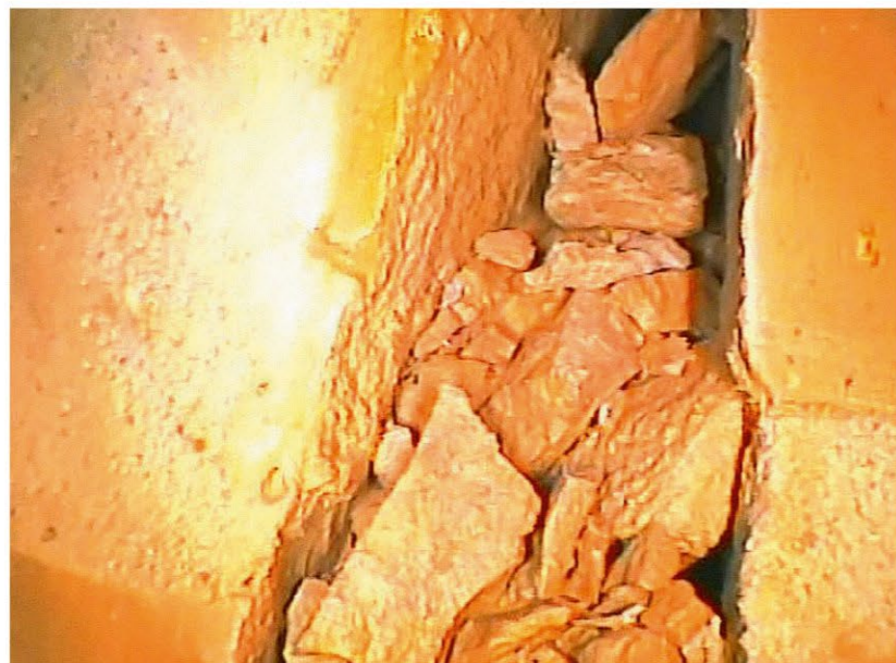
Bild 1: Schadensbeispiel Außenwand, massive Klüfte durch Überlastung im Altmauerwerk
