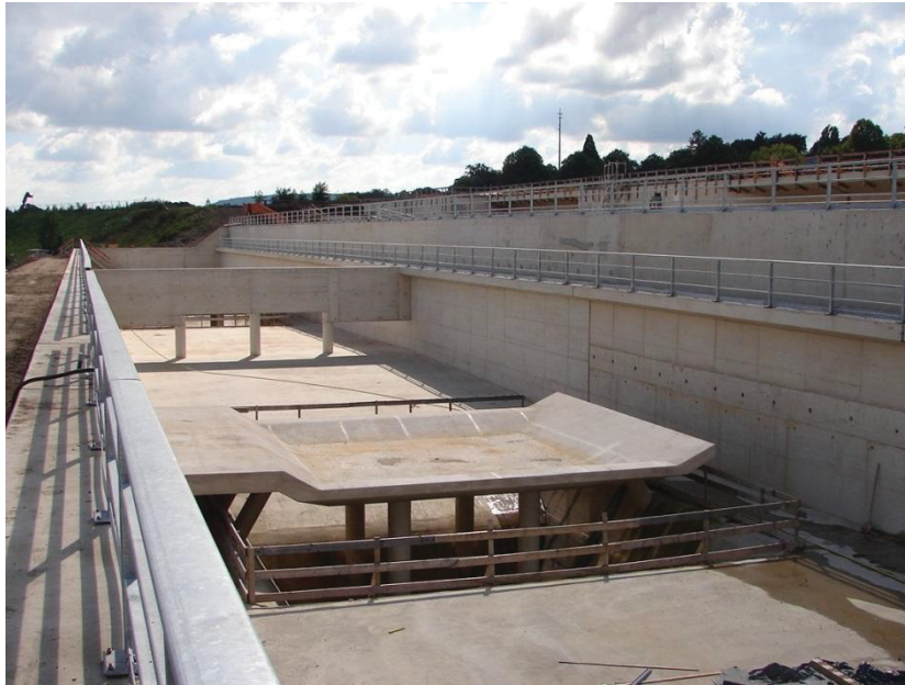
Bild 6: Sparbecken 2 mit Prallplatte über dem Sparbeckentrichter und Tauchwand in Beckenmitte.
