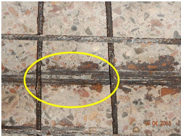
Abb. 2: Spanndrahtbruch (gelb markiert) in der Fahrbahnplatte einer Autobahnbrücke (Baujahr 1972) infolge Chloridkorrosion
