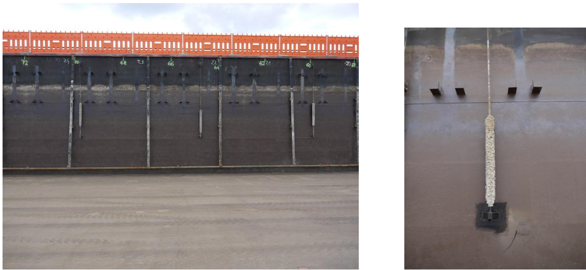
Bild 4a und 4 b: Beispiele des Korrosionsschutzzustandes der Troginnenseite (Rednitztalbrücke, 2012)
