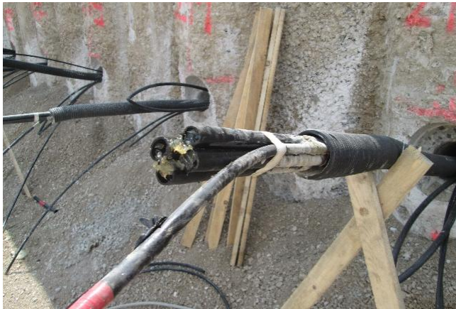
Hier: mit Korrosionsschutzmasse gefüllte PE-Hüllrohre
