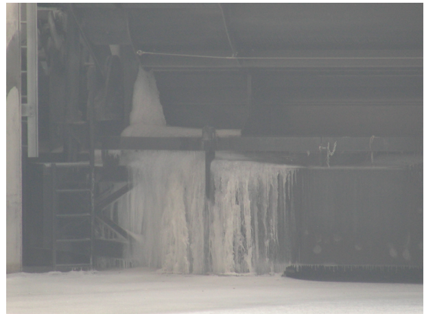
Bild 2: Eisbildung durch defekte Seitendichtung
