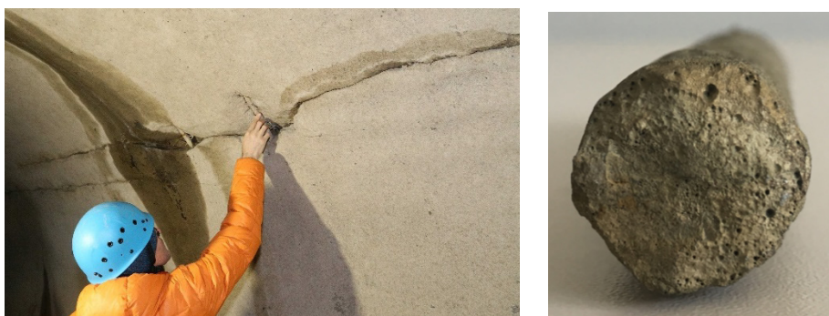
Abbildung 4: Durchtrennte Bewehrung im Riss im östlichen Umlaufkanal der Westkammer (links), Bewehrungsprobe nach dem Beizen (rechts)
