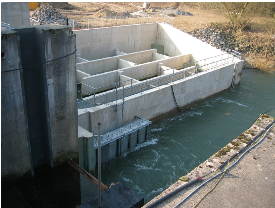
Bild 4: Verstellbare Lamellen an der Einstiegsbucht in den Vertical Slot Pass am Kraftwerk Nassau/Lahn. Die Lamellen waren zum Zeitpunkt der Aufnahme geschlossen
