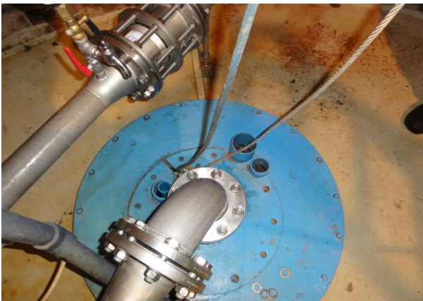
Bild 8: Brunnenkopf mit ungenügend abgedichteten bzw. verschlossenen Öffnungen (Eindringpfade für Tiere)
