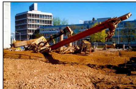
Abb. 1: Bei Bohrarbeiten 5-Zentner-Bombe angebohrt
