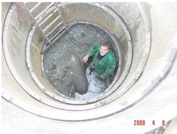
Bild 8: Bombenfund in einem Ringverbau Quelle Fa. Schollenberger 2008
