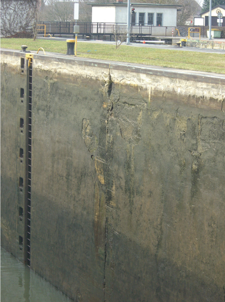
Bild 2: Betonschäden in der linken Kammer der Schleuse Schwabenheim
