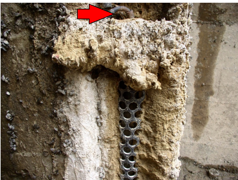
Bild 2: Verkalkung eines Anodenkorbes; oben: freiliegendes Kabel
