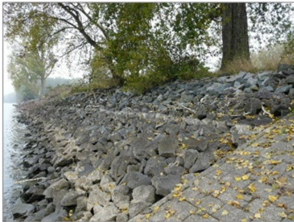
Zustand vor der Baumaßnahme 2016 (Quelle: WSA Oberrhein)
