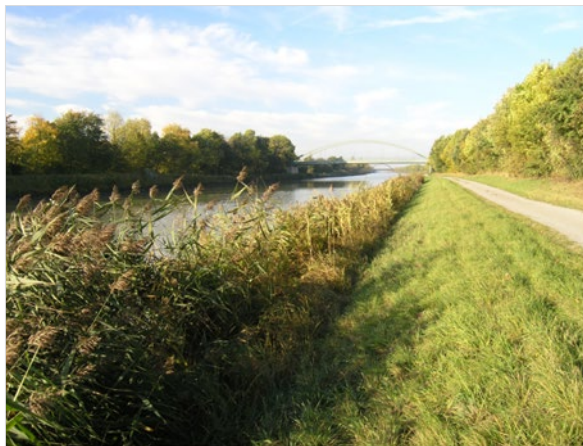
Üppiger Bewuchs hinter der Spundwand 10/2005 (Quelle: BAW)
