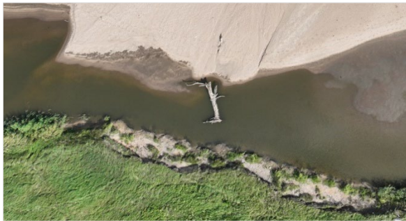
Böschungsabbrüche am Ufer hinter dem Parallelwerk 26.08.2025 (Quelle: WSA Oder-Havel)
