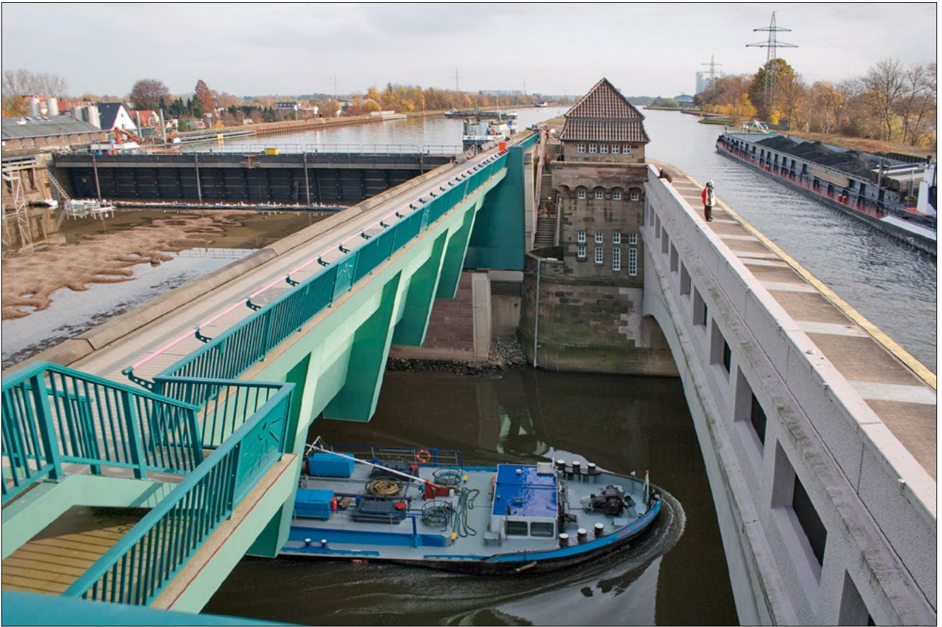
Bild 8: Eingebauter Revisionsverschluss Widerlager Ost (2009)
