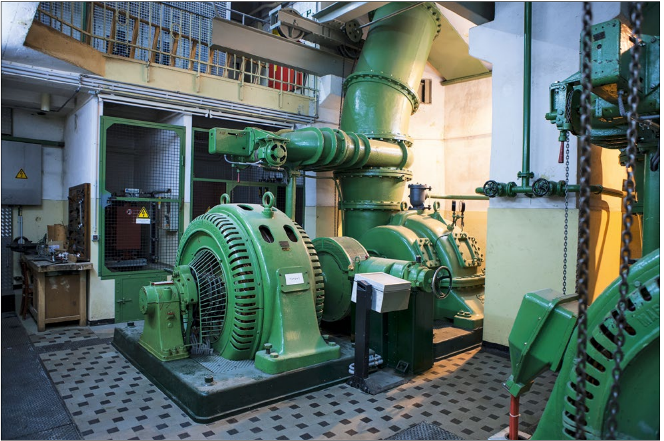
Bild 12: Hilfspumpwerk Minden – Spiralgehäusepumpe (2014)
