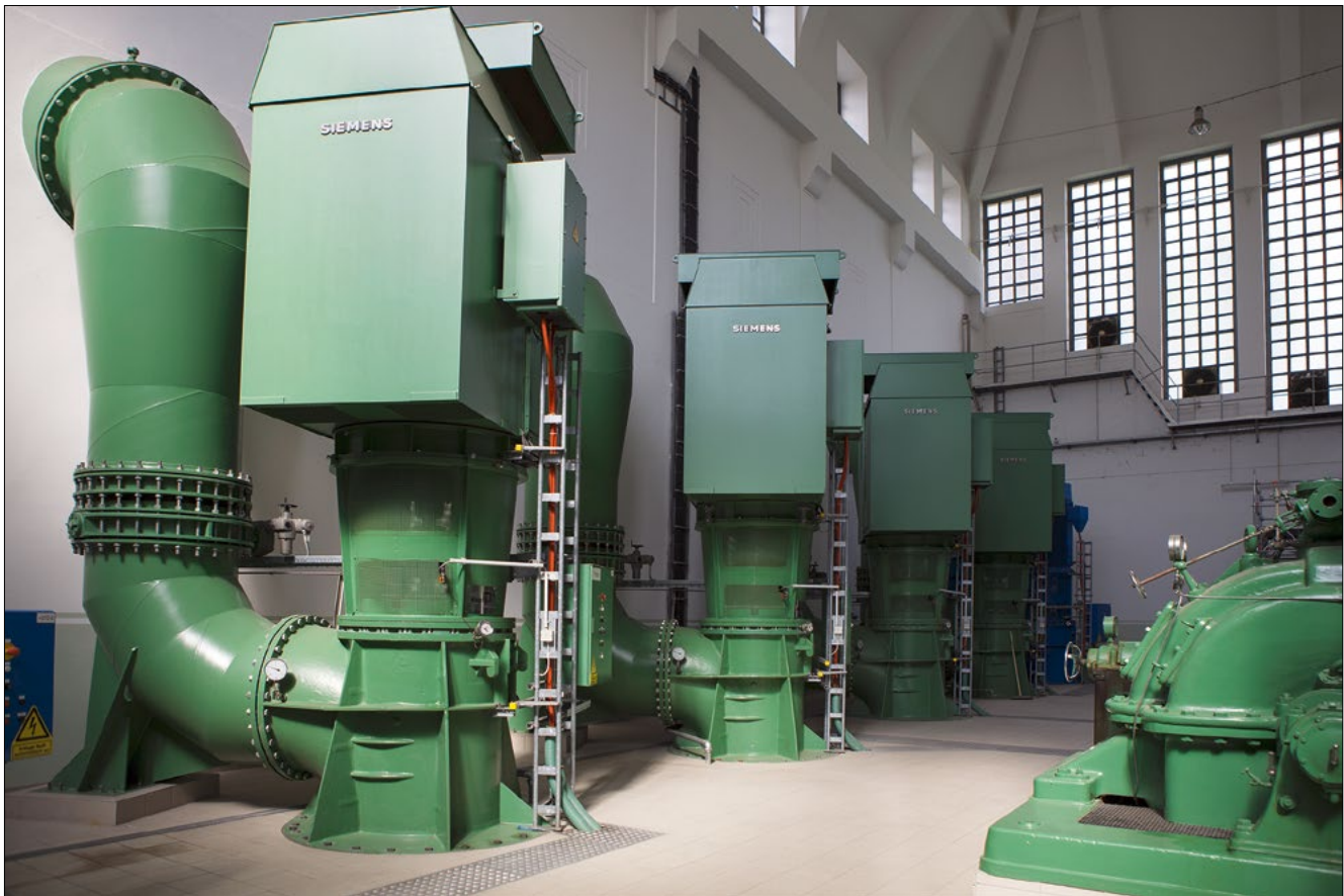
Bild 11: Hauptpumpwerk Minden – Pumpenhalle mit Rohrgehäusepumpen (2014)
