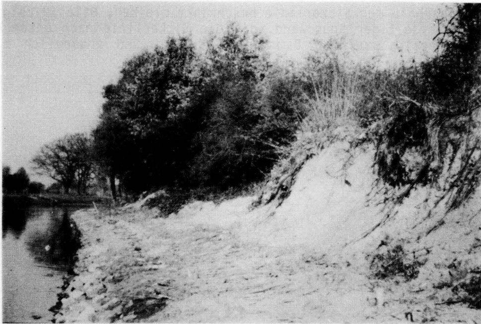
Bild 20: Uferverbau Varloh a. d. Ems: Buschmatten; übererdete Grünlagen; Steilböschungen bleiben erhalten, Bühnenbestand wird geschont
