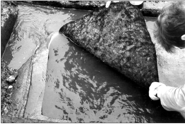
Bild 8: Blick unter das Geotextil einer verockerten Entwässerungsöffnung
