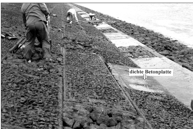
Bild 10: Provisorisch mit einer Betonplatte wieder verschlossene Entwässerungsöffnung
