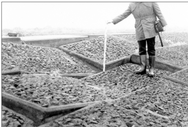
Bild 3: Sturmflutschäden am 3. Januar 1976
