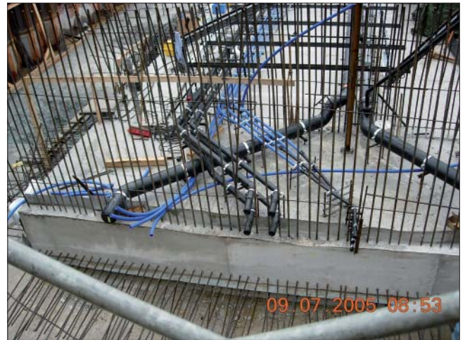
Bild 2: Rohrleitungssystem im rechten Wehrfeld
