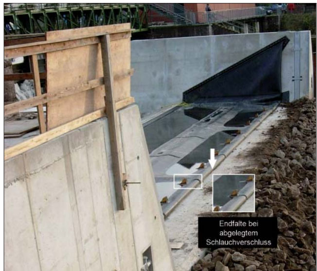
Bild 1: Endfalte bei gelegtem Verschluss und mit aufgesetzten Störkörpern
