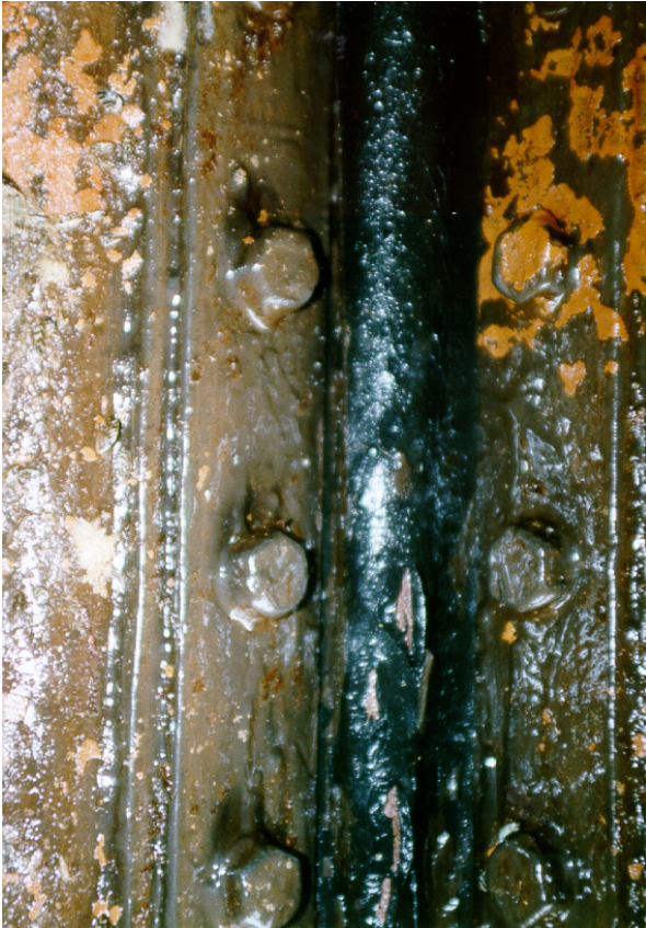
Bild 2: Schaden an einem Fugenband
