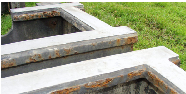
Bild 4: Elektrochemische Korrosion (Bimetallkorrosion) an einem Revisionsverschluss
