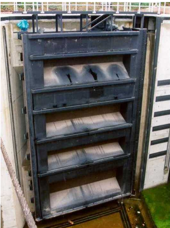
Bild 6: Linker Torflügel eines Faltwerk-Stemmtors (ohne Füllschütze)
