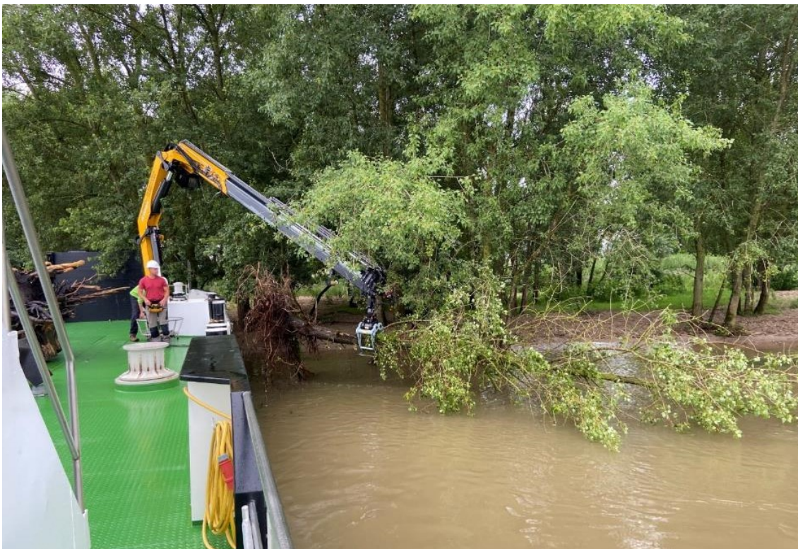
Abbildung 4: Bergung Gefahrenbäume im Uferbereich
