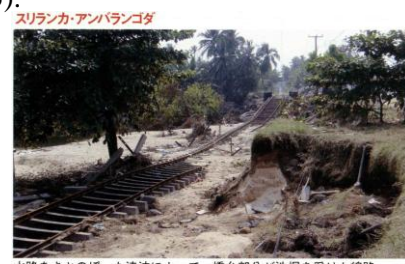
水路をさかのぼった津波によって、橋台部分が洗掘を受けた線路 (写真と資料：右ページも京都大学防災研究所)
